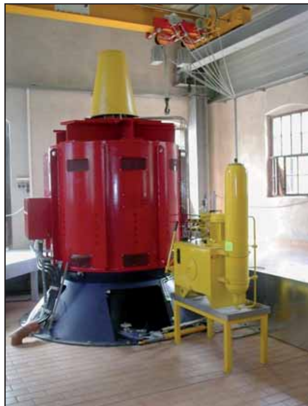
Turbine TD4-178 mit direktgekoppeltem Generator
